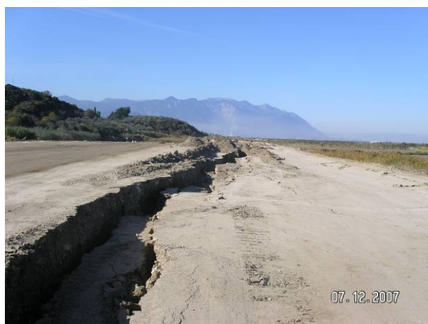
Σχήμα 2. Άποψη αστοχίας Figure 2. View of failure
